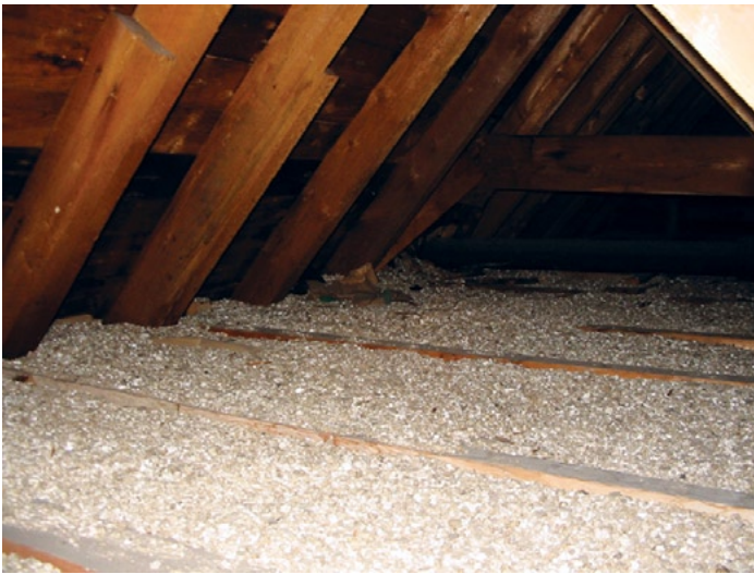
L'Agence de protection de l'environnement des États-Unis (EPA) conseille d'agir comme si tout isolant de vermiculite contient de l'amiante.
